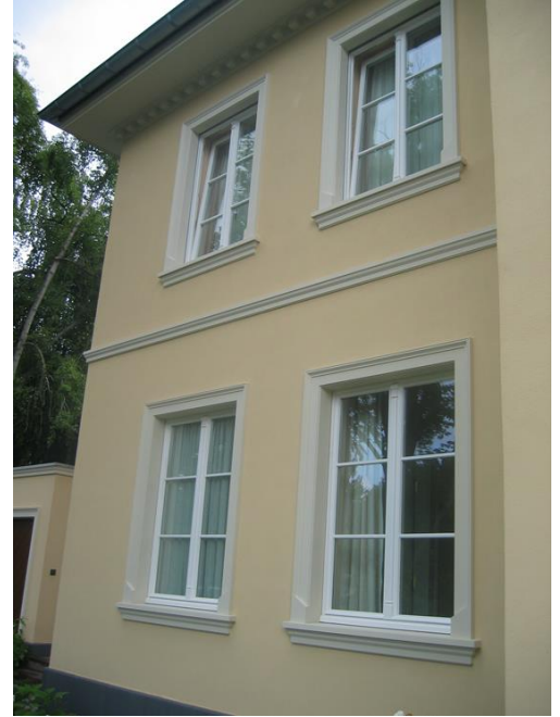
Fassadengestaltung mit SLB 500 Fensterbank, Schalen-Winkelgewände SLG 500 mit Fußteil und Gesimsprofil GP 14-06 zur Unterteilung der Geschosse
