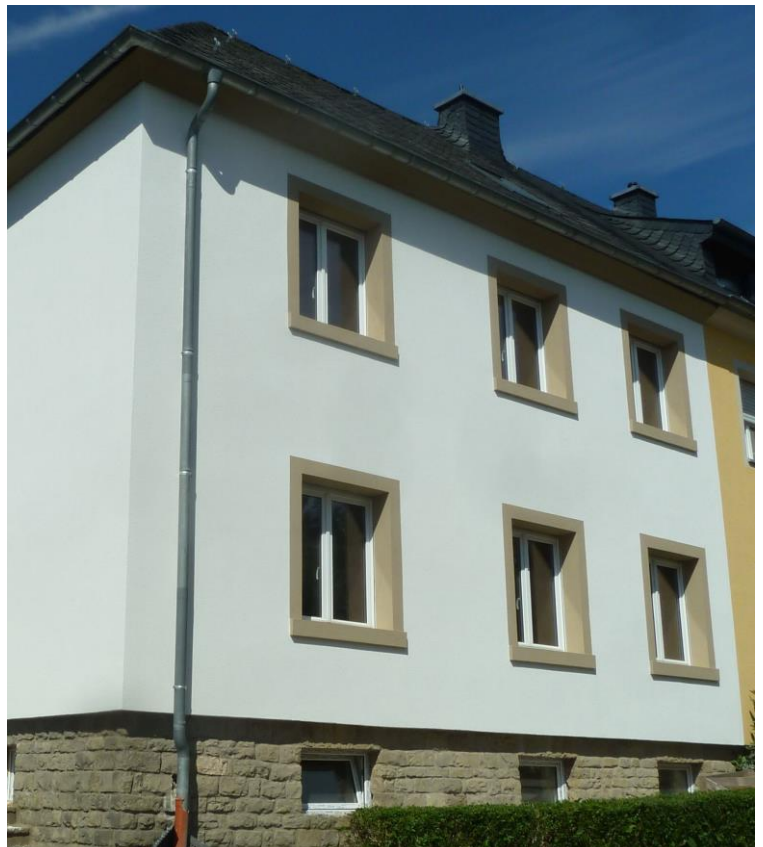
Gestaltung einer Hausfassade mit SLB 450. Die schlichten farbigen Fensterumrahmungen schließen seitlich mit der kantigen Fensterbank ab.
