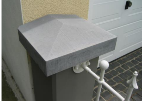
PAR Walmdach, bauseits für einen an der Hauswand stehenden Pfeiler eingekürzt.
