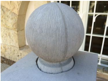
Die Kugel mit Fußteil wird mit dem Unterteil vor Ort verklebt. Die hier noch sichtbare Fuge wird dauerelastisch geschlossen.
