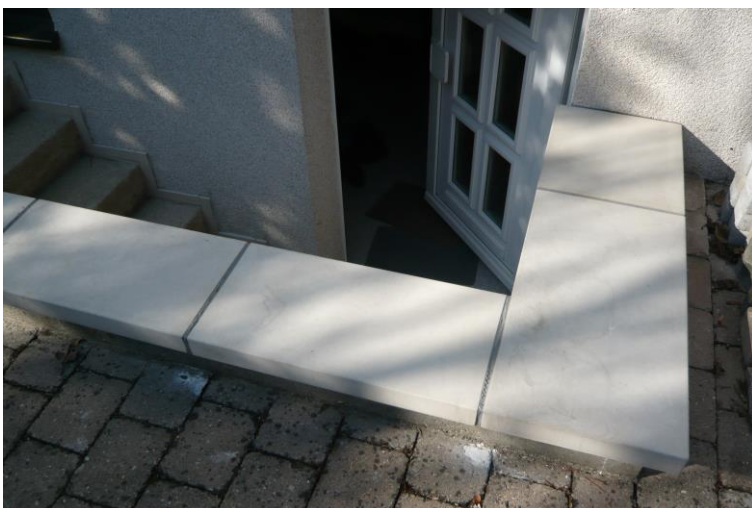
Eckausbildung 90 Grad mit MFU Endstück in durchgefärbt weißgrau. Das Endstück wurde vor Ort unterseitig in Mauerbreite ausgeklinkt.
